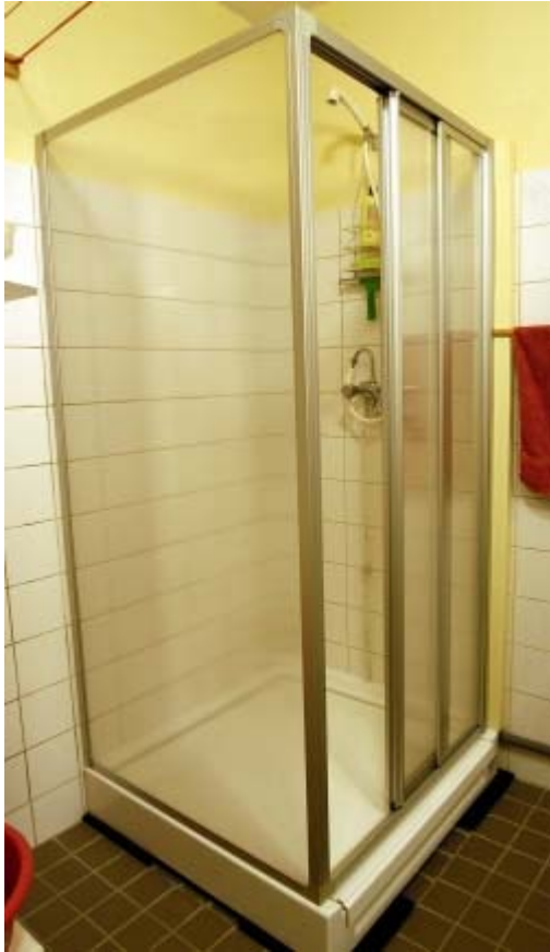
Fig. 7. Douchebak en –cabine gereed voor gebruik.
